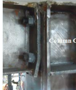
(d) Gap in the connection
