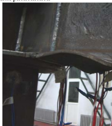
(d) Buckling of beam in joint B
